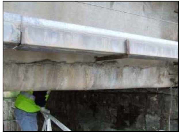
Figura 3 – Particolare delle lesioni.
