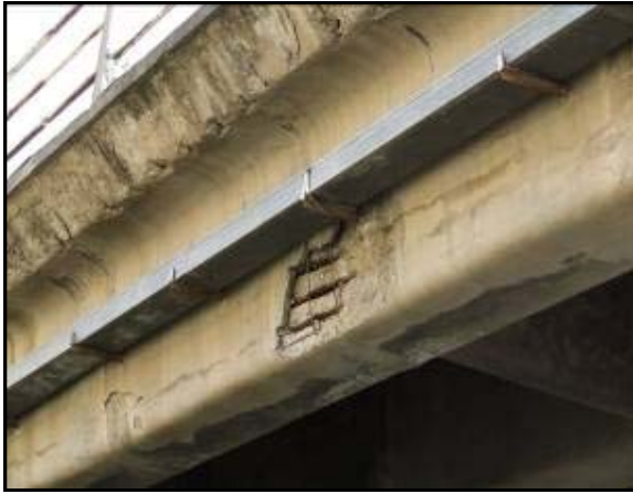
Figura 2 – Spalling ed esposizione dei cavi.
