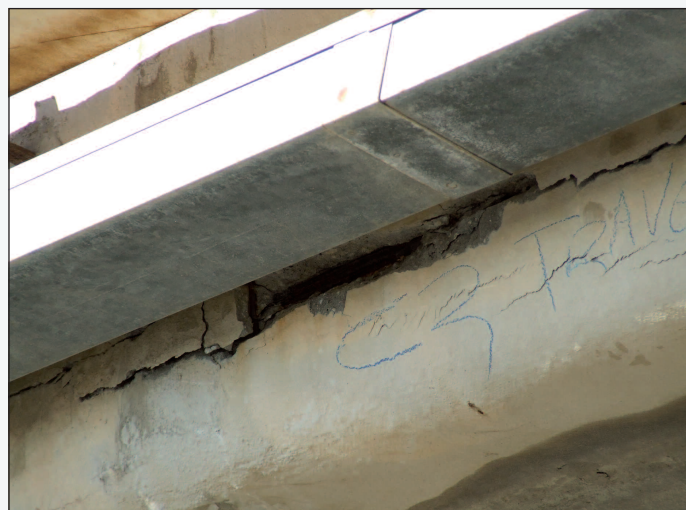
Figura 9 - Le lesioni in corrispondenza dei cavi
