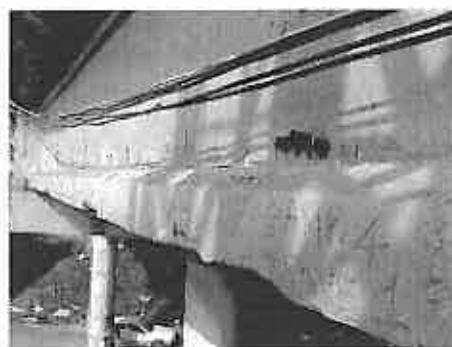
Figura 6. Distacchi sul martello inferiore delle travi.
