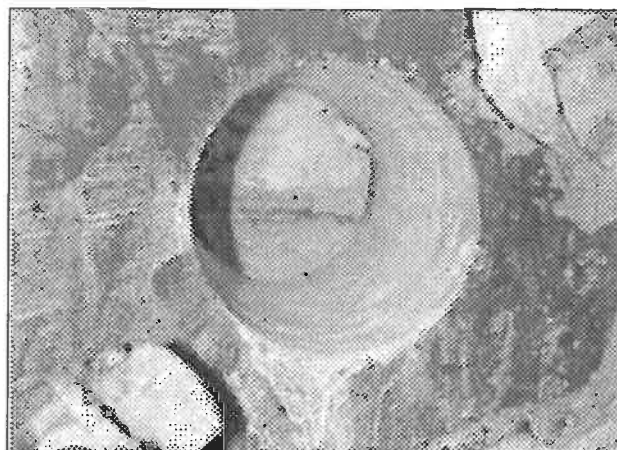
Figura 4. Lesione longitudinale di una trave sul fondo del foro lasciato dal carotaggio.
