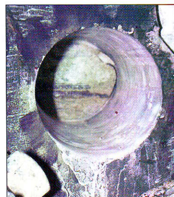
Figura 4 - La lesione longitudinale di una trave sul fondo del foro lasciato dal carotaggio
