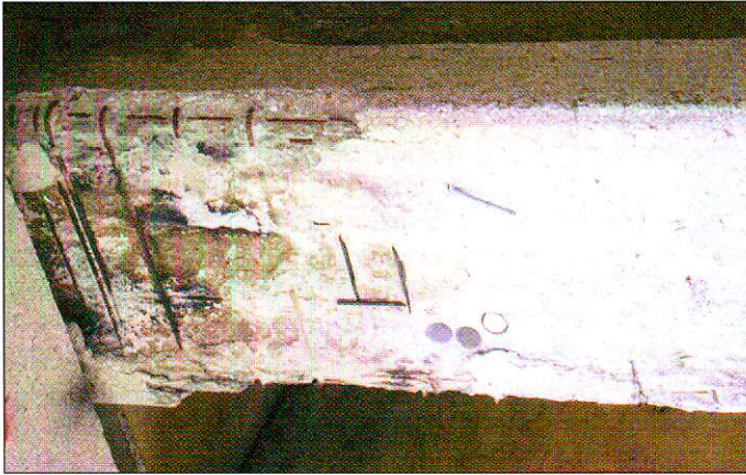
Figura 6 - Il corner spalling e l'esposizione diretta delle armature alla fiamma nell'intradosso della trave
